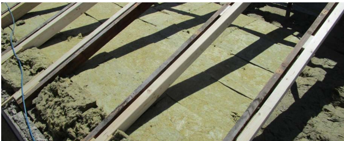
Abbildung 1: Mineralwolle aus dem Baustellenbereich
